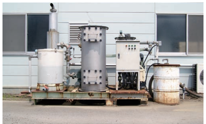
土壤浄化装置
