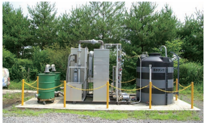
地下水浄化装置
