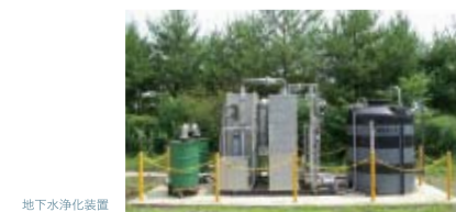
地下水浄化装置
