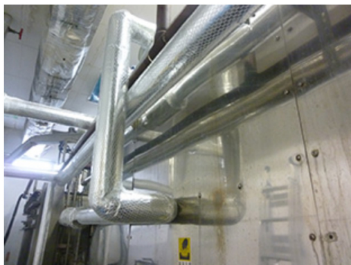
配管を保温し蒸気熱のロスを低減
