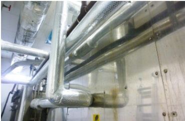
配管を保温し蒸気熱のロスを低減する
