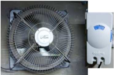
温度センサ取り付けにより不使用時は自動停止する設定へ
