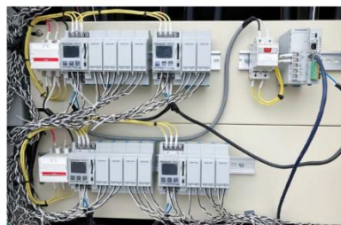
分電盤へ電力測定器を取り付け使用電力を見える化
